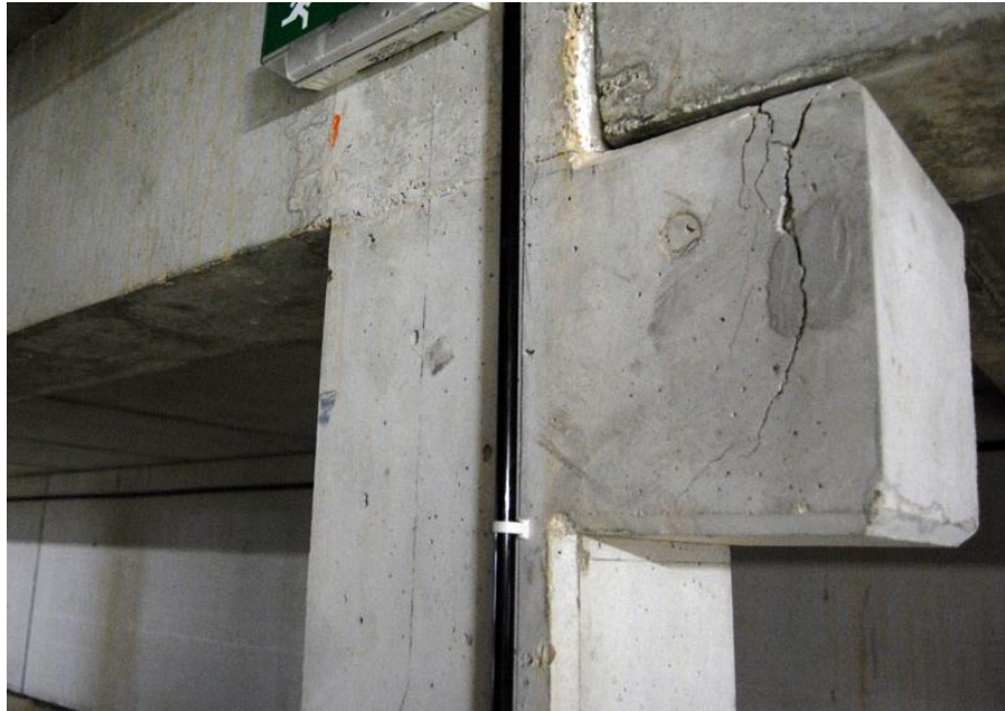
Figure I. 1 : Fissuration d'un corbeau en béton armé [3].
