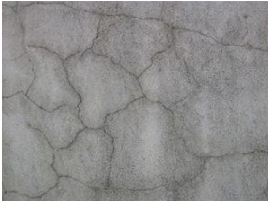
Figure I. 2: Fissuration de retrait « dalle en béton armé ».
