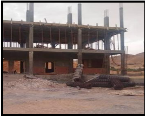
Figure.1.11. Mauvais stockage de ferrailage
