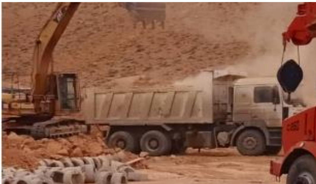
Figure.1.8. camions de transport des matériaux (gravier ou sable).
