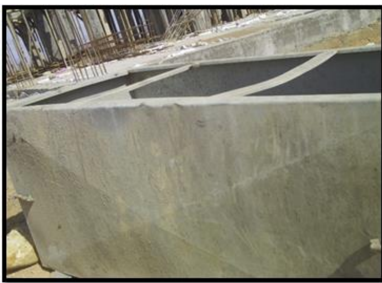
Figure.1.17. stockage de l'eau.
