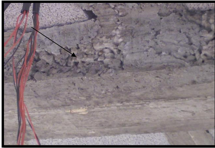
Figure.1.60. présence de la ségrégation dans la poutre.
