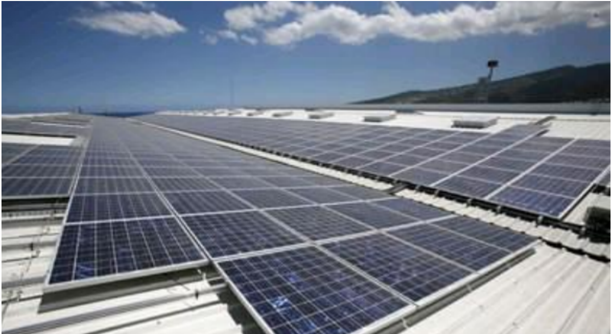
Fig.2.3 : une centrale solaire
